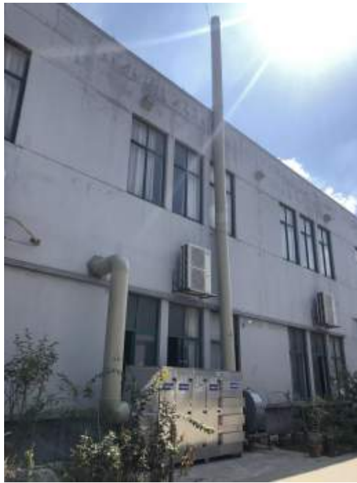
“干式过滤器+UV 光解净化器+活性炭吸附塔”+15m 高排气筒
