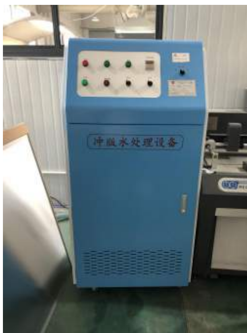
图 4-1 冲版水处理设备
