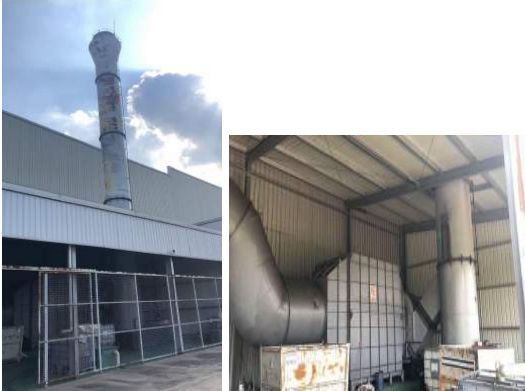
油雾废气排气筒及过滤式油雾废气处理设施
