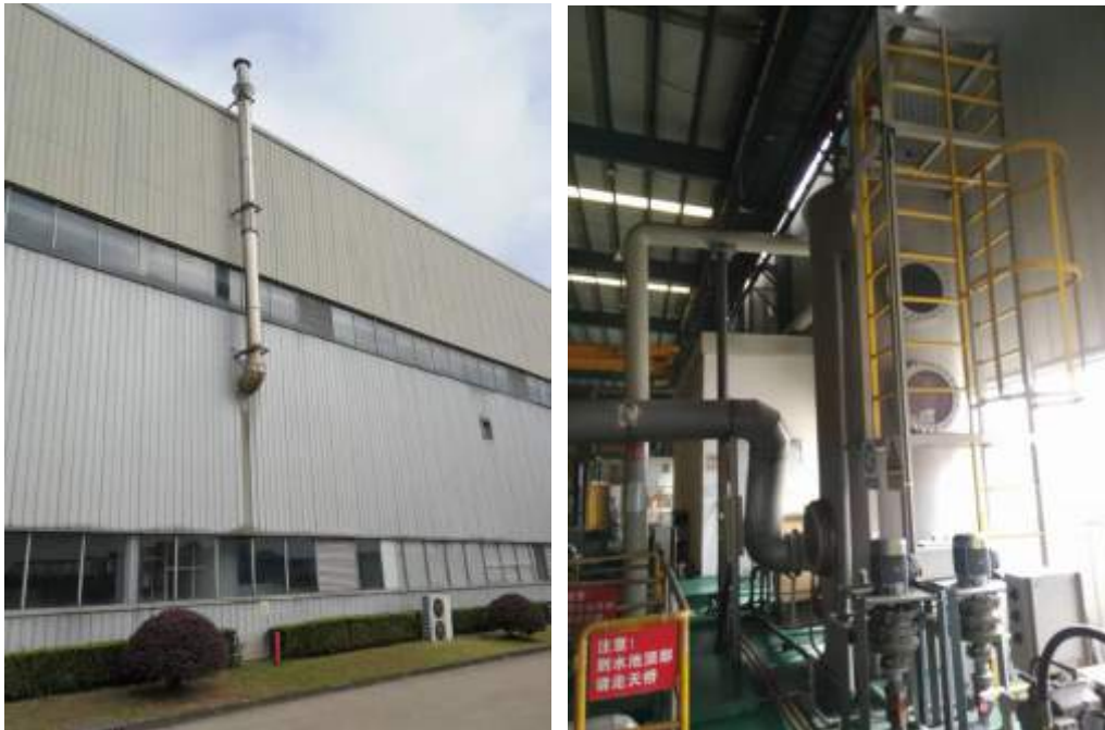
南侧碱雾废气排气筒及水喷淋处理设施
