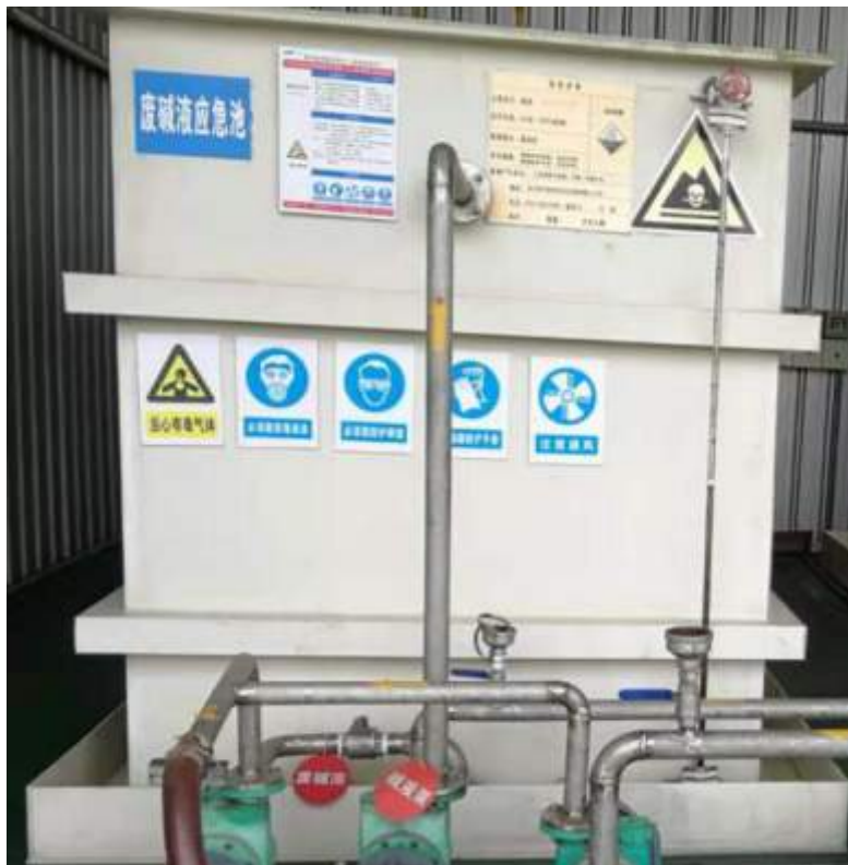
危废标识+废碱液应急池
