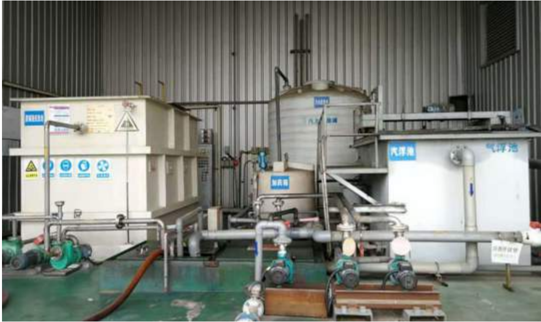
废水处理设施
