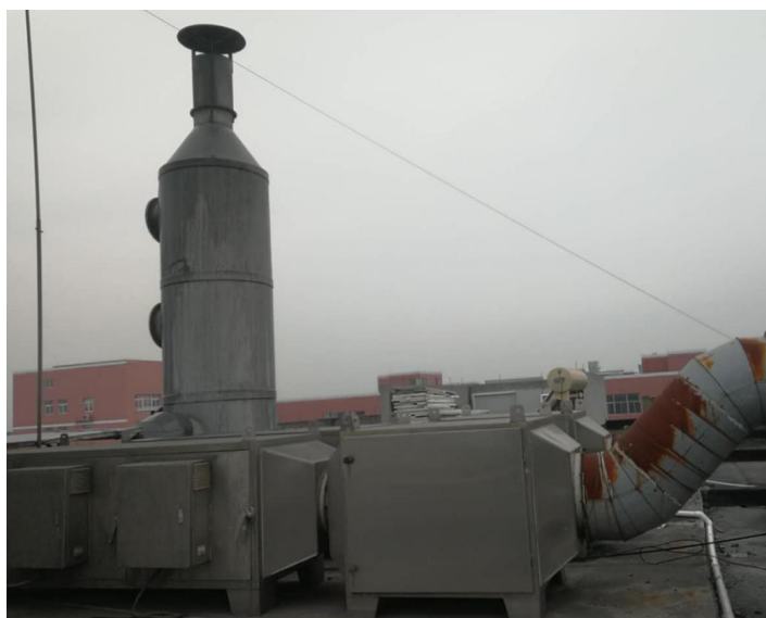
图 4-3 部分废气处理设施图（喷漆废气处理设施）
