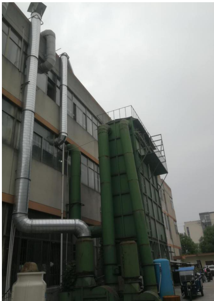
制扣粉尘废气处理设施
