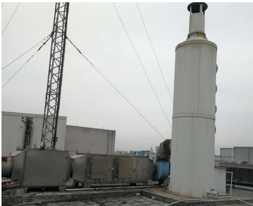
苯乙烯废气处理设施
