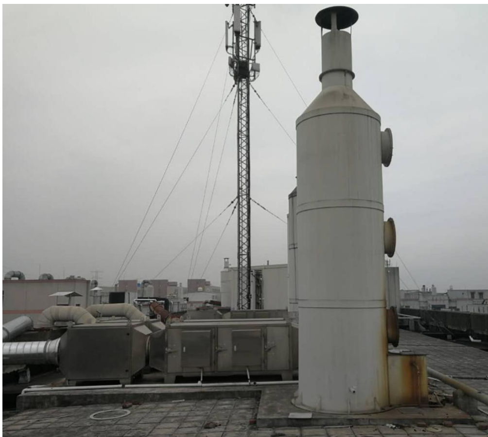
喷漆废气处理设施
