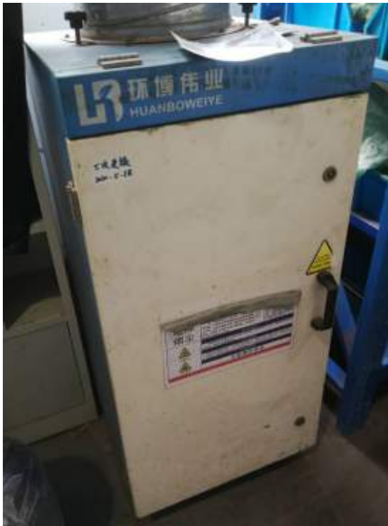
废气处理装置
