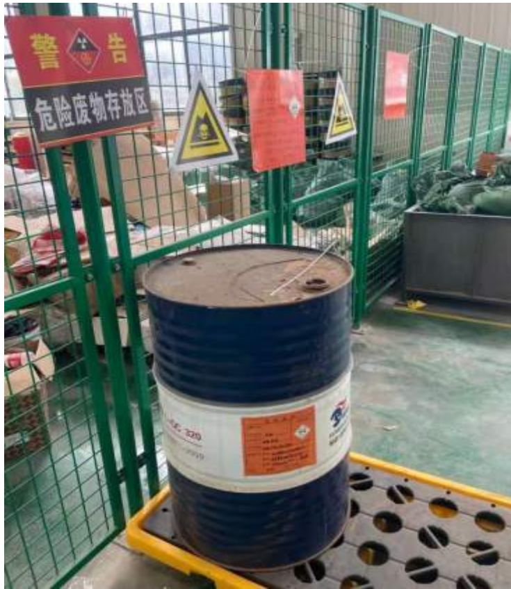
危废标识+防渗漏托盘
