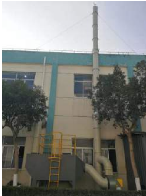
活性炭吸附+排气筒装置
