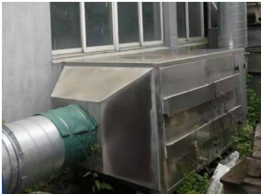
活性炭吸附净化装置
