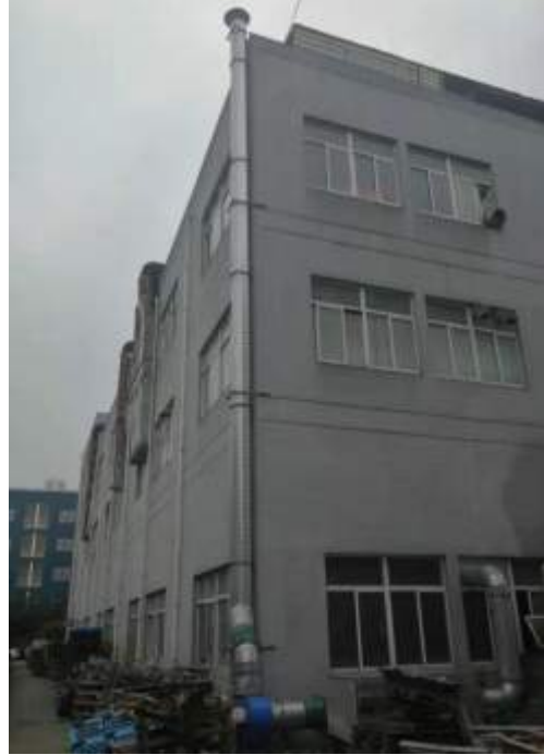
排气筒高空排放
