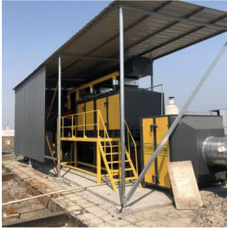
“干式过滤+活性炭吸附+催化燃烧”装置
