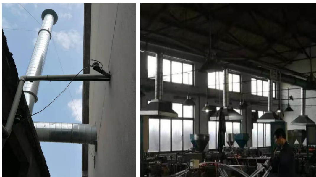
排气筒高空排放
