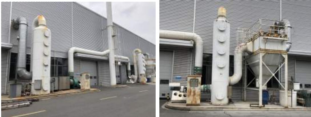
烧结废气处理设施
