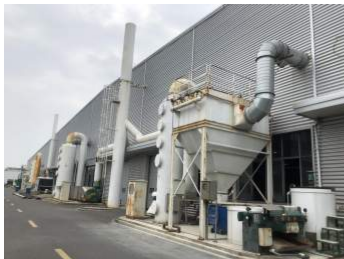
图 4-3 部分废气处理设施图
