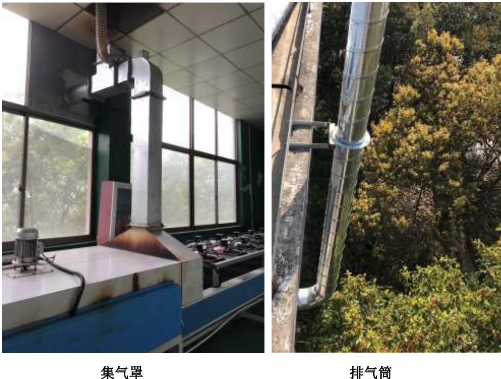
图 4-3 部分废气处理设施图
