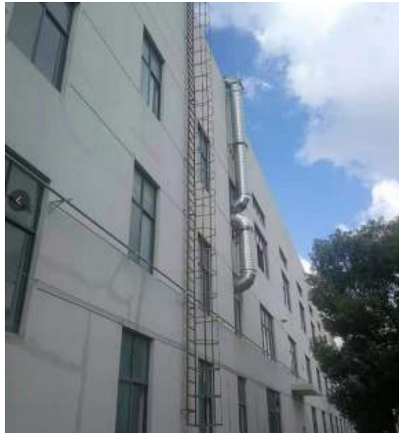
图 4-2 部分废气处理设施图
