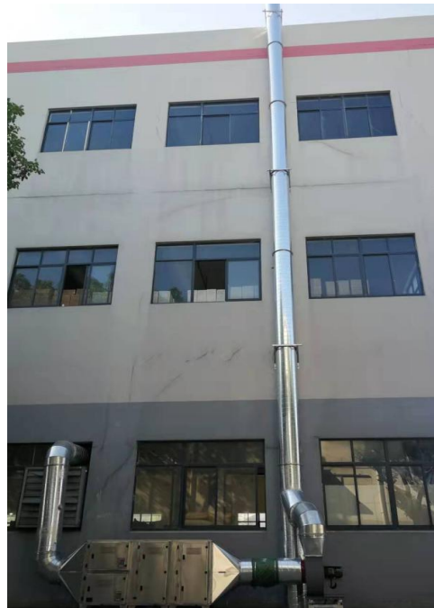
15m 高排气筒
