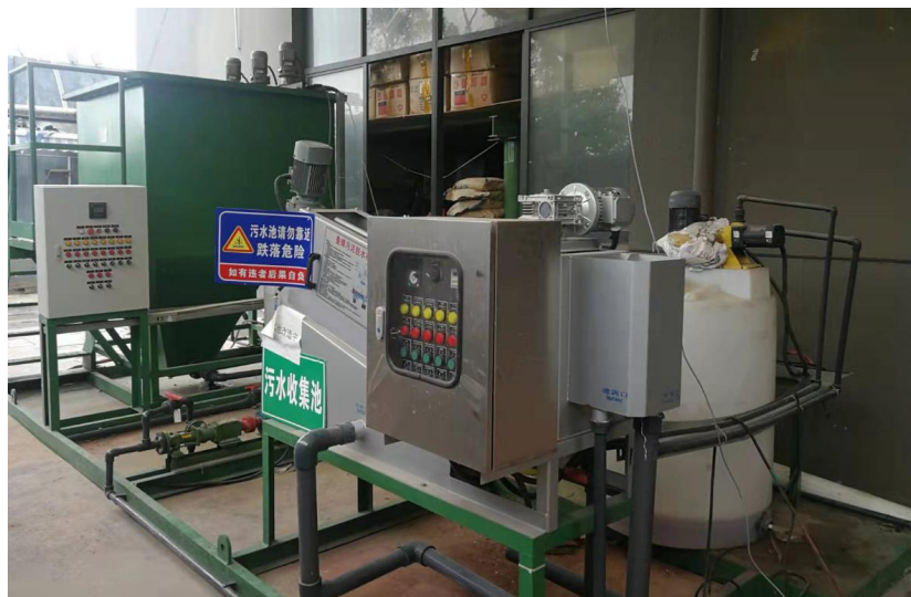
图 4-2 废水治理设施图
