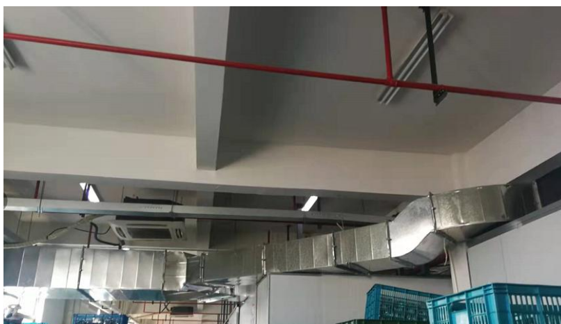
废气汇总收集管道
