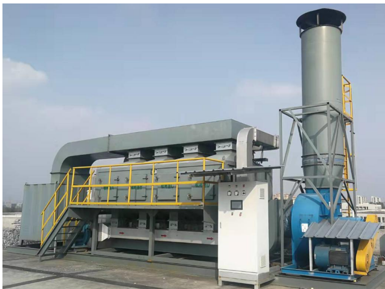
干式过滤+活性炭吸附浓缩+脱附催化燃烧装置
