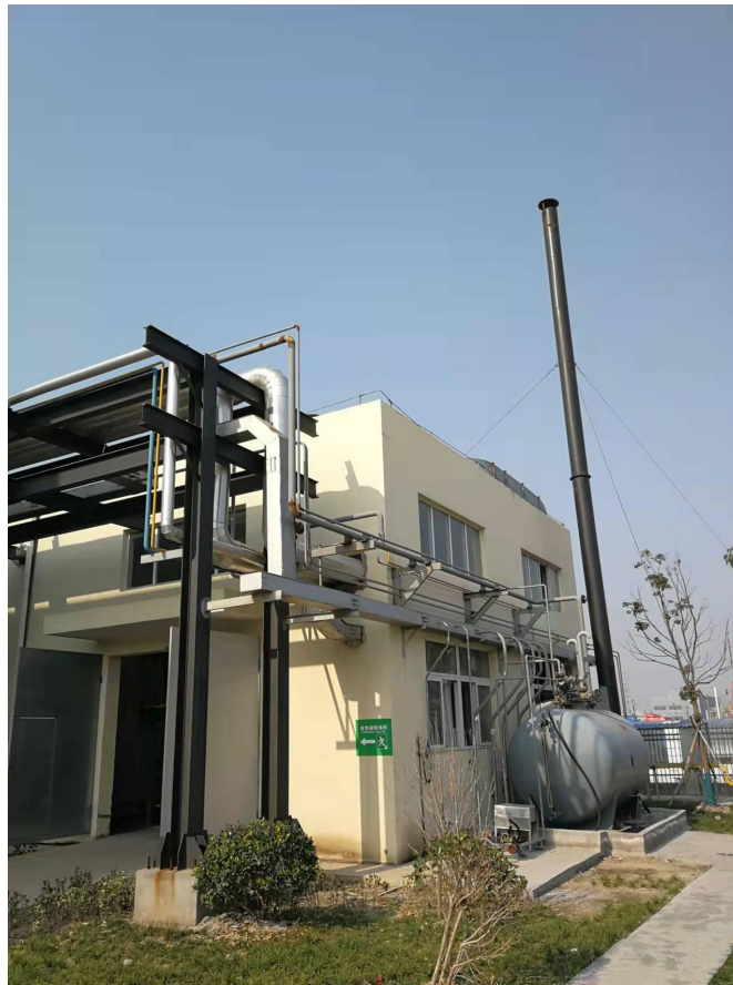
图 4-3 部分废气处理设施图
