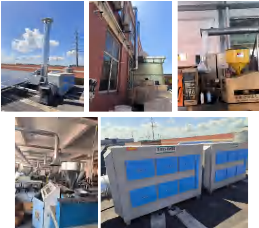
图 4-3 部分废气处理设施图
