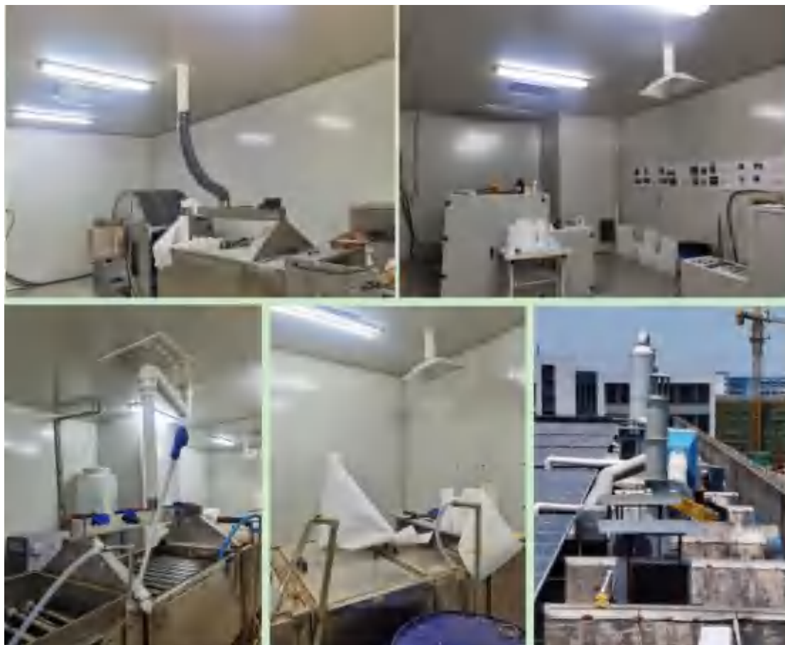
图 4-3 部分废气处理设施图
