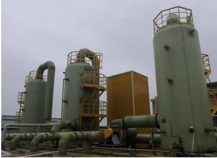
图 4-3 部分废气处理设施图
