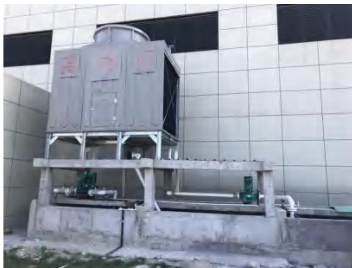
4-2 冷却塔循环水池
