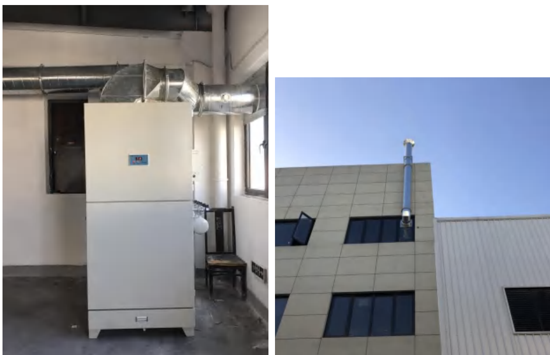
投料粉尘处理装置
