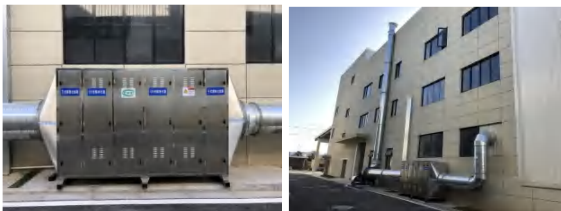
挤出废气处理装置
