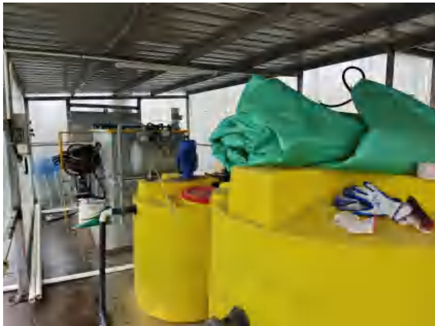
图 4-3 生产废水处理设施图
